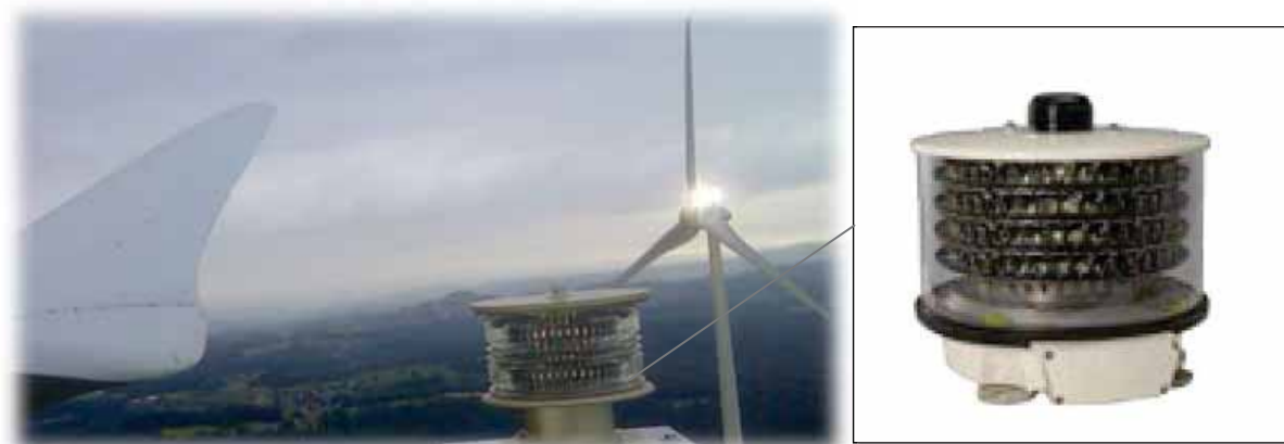
Figure 29 : Balisage d'une éolienne.
